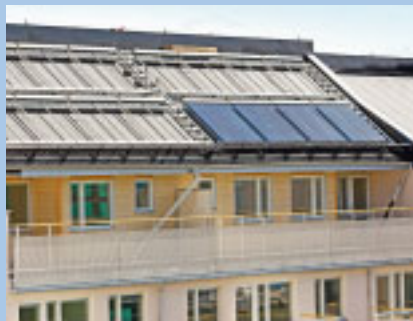
Hamnhuset i juli 2008. Solfångarna monteras på taken strax före inflyttningen.
