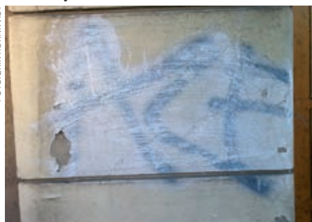
Klottersanering kan gå hårt åt fasaden.
