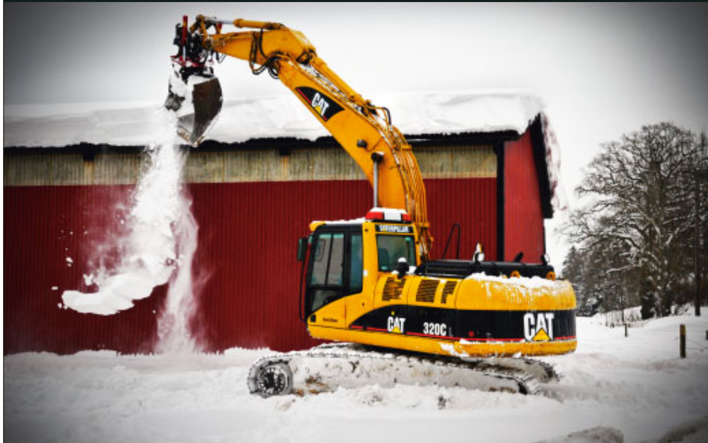
SKOTTA MED SKOPAN! Många tak har rasat in på ridhus, stall och idrottshallar den här vintern. På ett ridhus i Millingetorp utanför Kisa, Östergötland har man hittat ett kreativt sätt att skotta taket.
