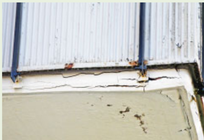
På den här tvåskiktetsbalkongen har armeringsjärnen rostade i framkant och infästningen av räcket angripits av rost. Har det gått så här långt bör du bilda ner hela betongplattan och gjuta nytt, enligt Roger Peterzon.
